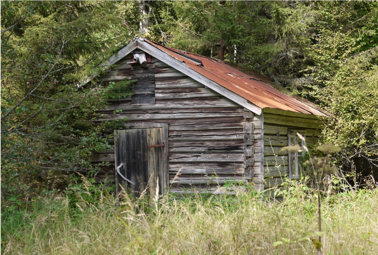
17360002060: Utmarkshusene har vært den mest utsatte bygningsgruppen i Snåsa gjennom alle tre omdrev av kontrollregistreringen. Foto: ÅD/NIKU 2013
