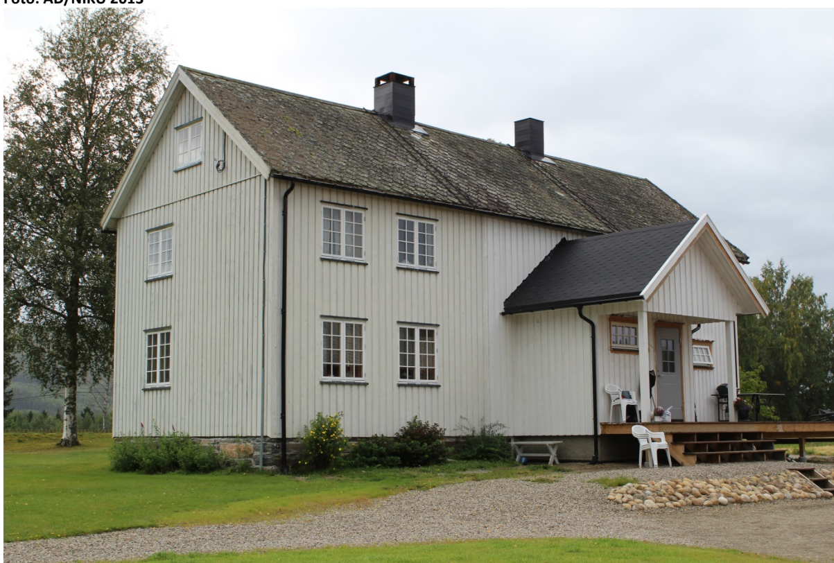
17360010059: Liten volumendring, for eksempel et tilbygd inngangsparti, registreres som B-endring. Foto: RM/NIKU 2013
