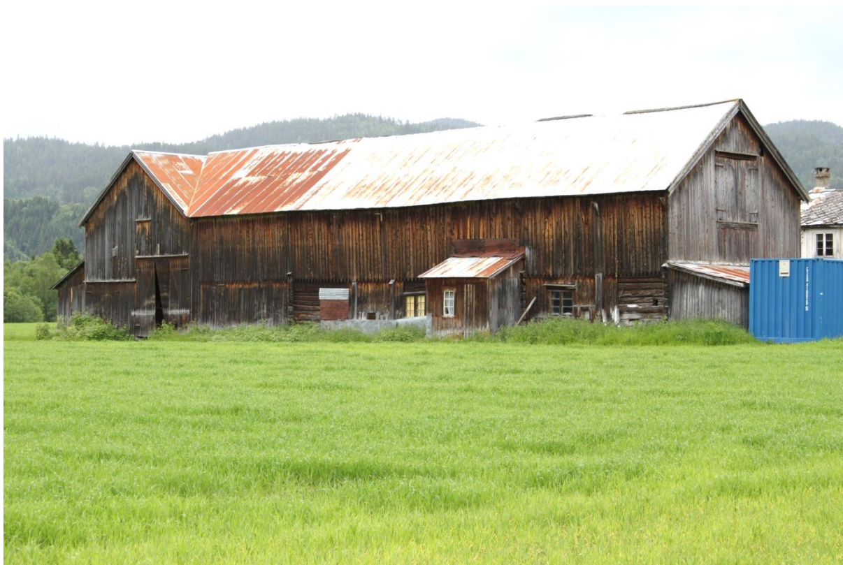
16530019025: Driftsbygningen på Midtlynge er registrert som uendret og intakt gjennom alle tre omdrev av kontrollregistreringen. Av de SEFRAK-registrerte husene i Melhus er imidlertid de større driftsbygningene en spesielt utsatt bygningskategori. Av de gjenstående SEFRAK-bygningene i kommunen er det driftsbygningene som er mest utsatt for forfall. Tapsandelen har økt fra 2. til 3. omdrev (fra 5 % til 6 %), 16 % er registrert som truet og 6 % som sterkt truet. Foto: JCE/NIKU 2013
