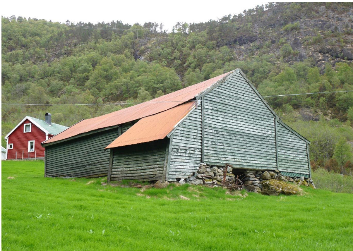
14010107009: Tapsandelen for de større driftsbygningene har økt i 3. omdrev (fra 5 % til 6 %). Til sammen er 16 tapt siden oppstart av kontrollregistreringene. 65 er gjenstående etter 3. omdrev. Foto: LM/NIKU 2013
