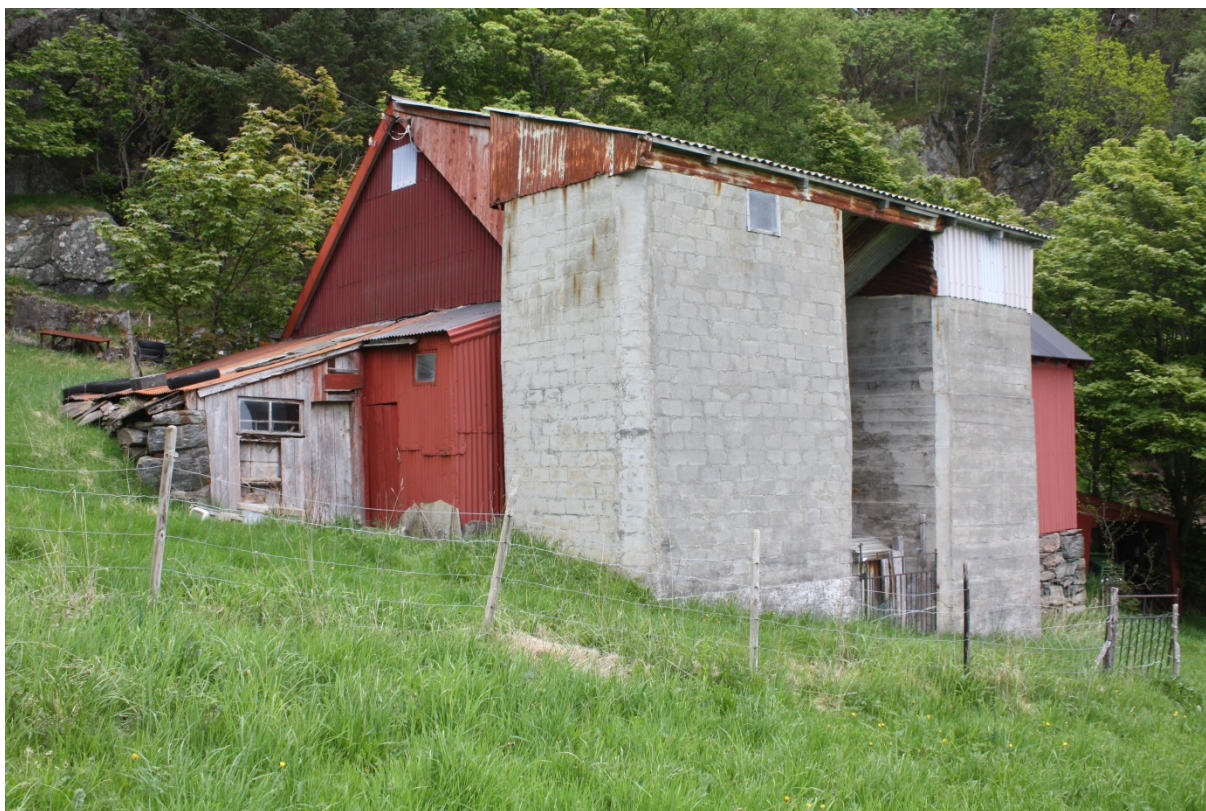
14010205009: Mens det var de mindre uthusene i tunet som var mest utsatt for tap i Flora i 1. og 2. omdrev, er det en tendens til økt tapstakt for de større driftsbygningene i 3. omdrev. Foto: RM/NIKU 2013
