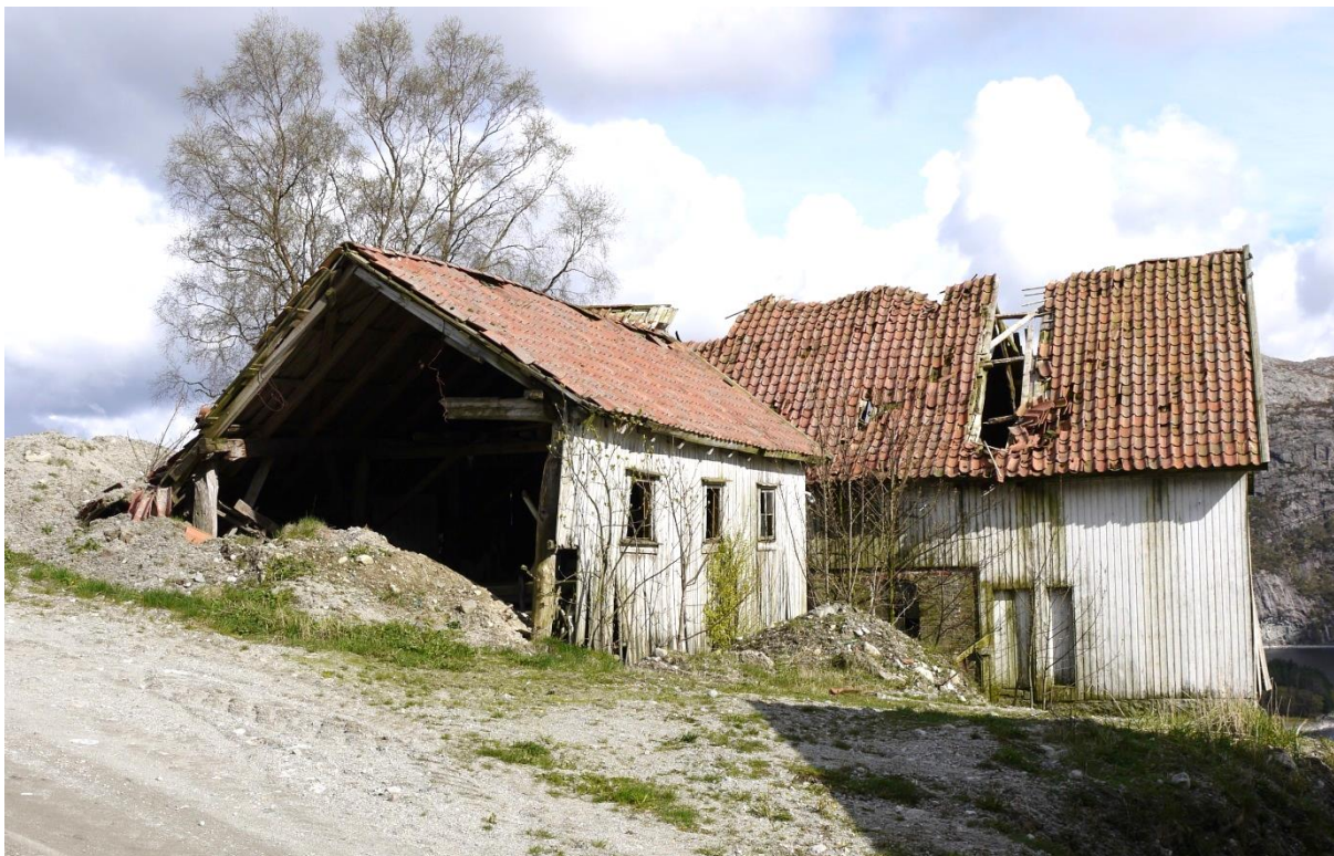
11020032021: Kun fem av de undersøkte SEFRAK-bygningene i Sandnes kommune er sterkt truet. Alle fem tilhører kategorien bonde, som betyr at 2 % av bondens bygninger er sterkt truet. I tillegg er 14 % av bondens bygninger registrert som truet. Foto: JS, NIKU 2012.
