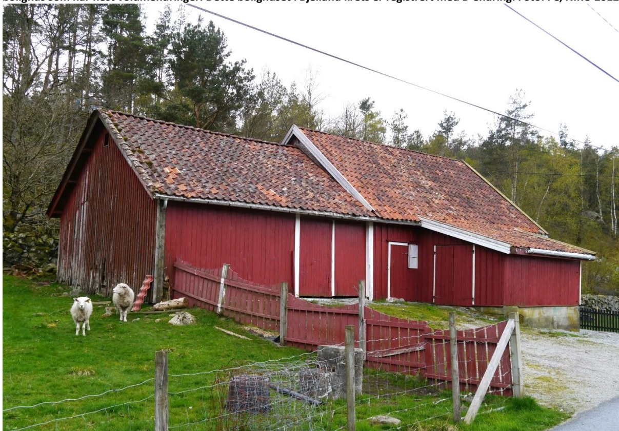
11020030065: I noen av tilfellene hvor det er registrert volumendringer, er deler av bygningen fjernet, slik som denne driftsbygningen i Lauvås krets, som er registrert med B-endring. Her er et lite takoppløft over inngangsdøren til venstre for utbygget fjernet. Foto: FC, NIKU 2012.
