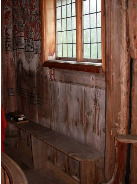
Fukt- og vannskader på sydveggen.
